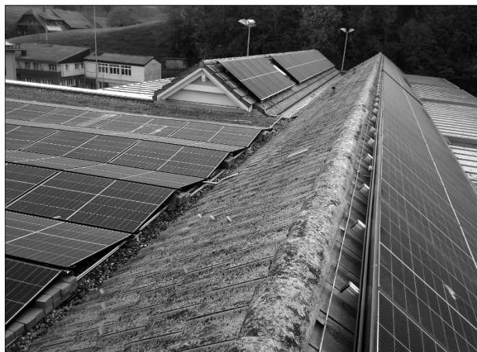
Neue PV-Anlage auf dem Dach des Schulhaus Steinacher
